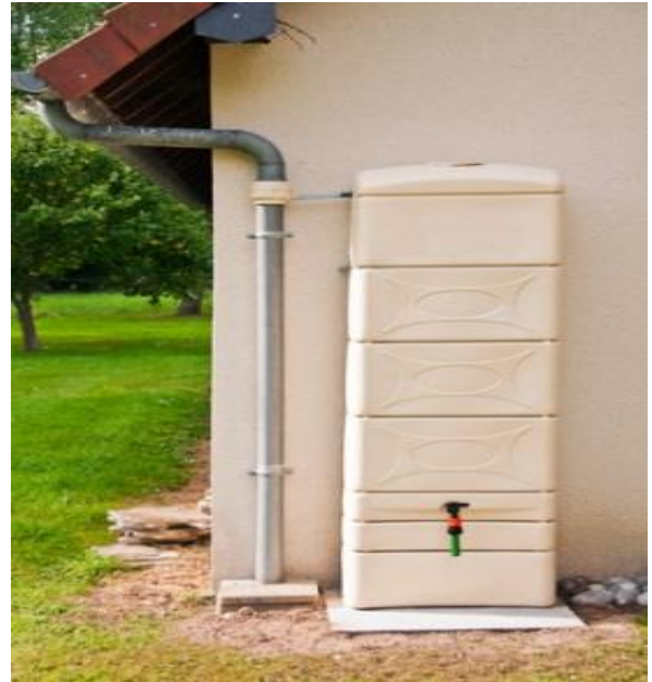
Systeem voor de recuperatie van regenwater langs de voorgevel
